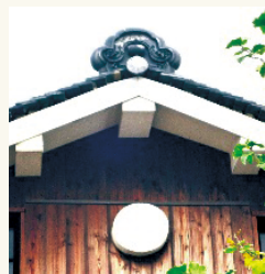
改修前の蟻羽と 牛梁の木口
